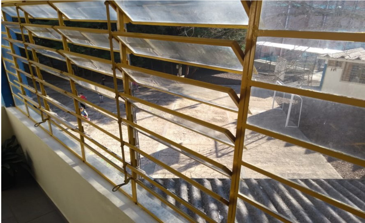
Figura 3 - Sala 11, com janela que apresentava problemas de vedação.
