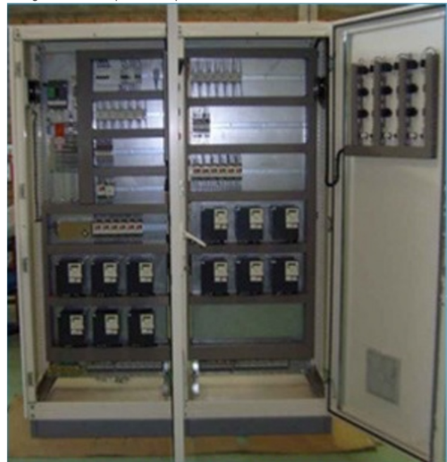
Fotografia 1 – Exemplo de um painel elétrico industrial
