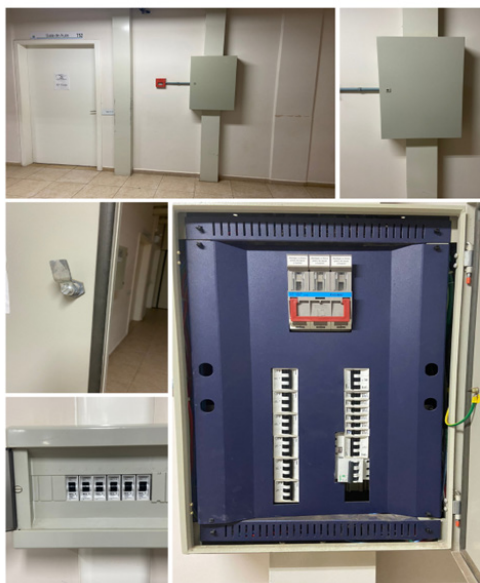
Fotografia 1 – Quadros e Painéis não adequados
