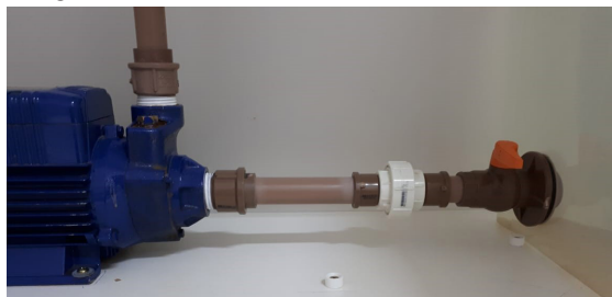
Fotografia 1 – Conexões entre a bomba e o reservatório
