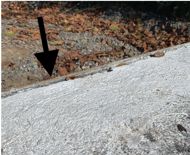
Fotografia 1 – Recalque na rampa
