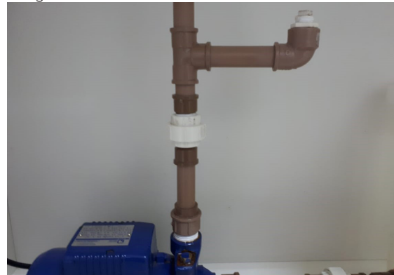
Fotografia 2 – Conexões na saída da bomba
