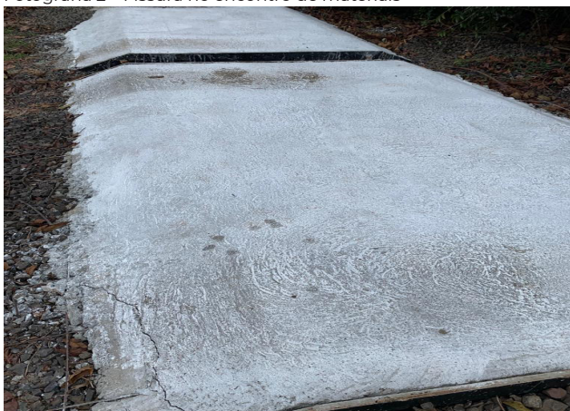
Fotografia 2 – Fissura no encontro de materiais
