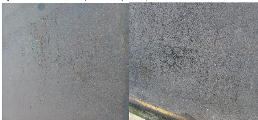
Figura 3: Trinca isolada (couro de jacaré)
