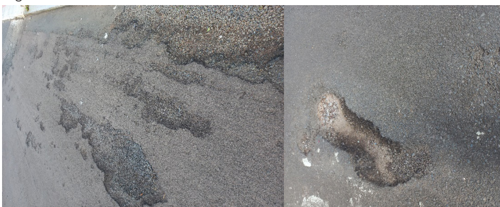
Figura 6: Painelas ou buracos
