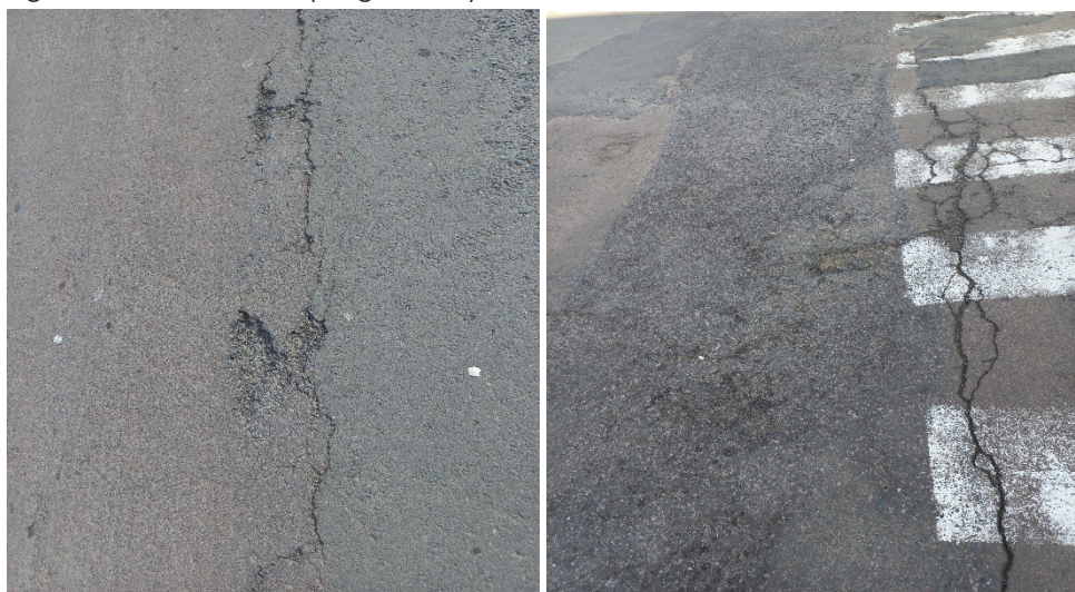
Figura 2: Trinca isolada (longitudinal)
