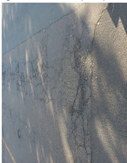
Figura 4: Trinca isolada (bloco)
