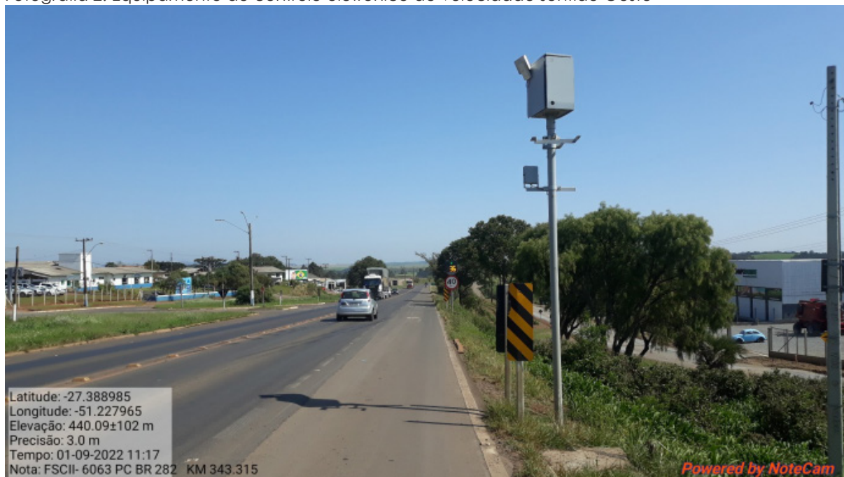
Fotografia 2: Equipamento de controle eletrônico de velocidade sentido Oeste
