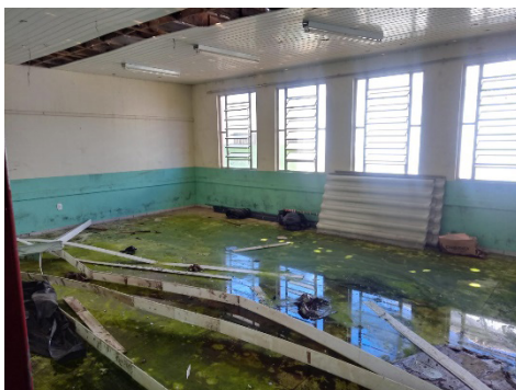
Fotografia 20 – Mofo, bolor e mancha de umidade
