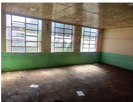
Fotografia 11 – Mofo, bolor e manchas de umidade
