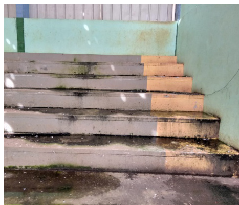
Fotografia 25 – Mofo, bolor e mancha de umidade
