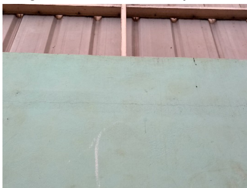
Fotografia 22 – Trinca de dilatação térmica
