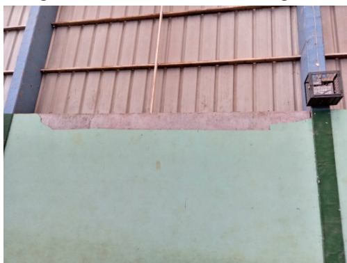
Fotografia 23 – Descolamento de argamassa
