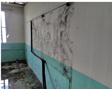
Fotografia 17 – Mofo na parede
