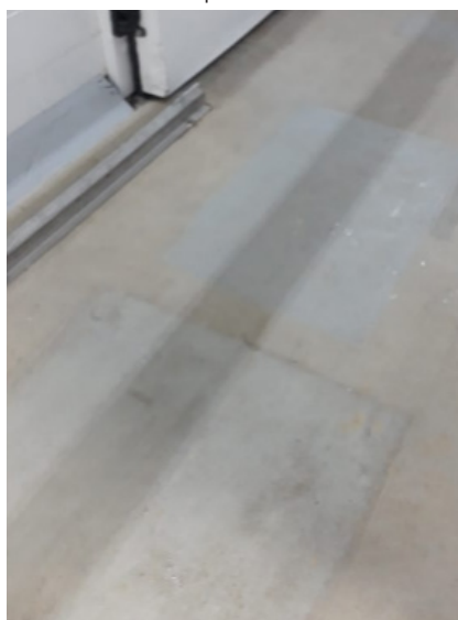
Fotografia 7 - piso com manutenção aparente
