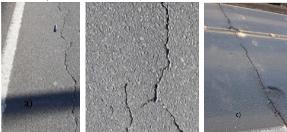
Fotografia 3 - a) Trinca longitudinal, b) Trinca longitudinal - ampliação, c) Patologias presentes na cabeceira da ponte
