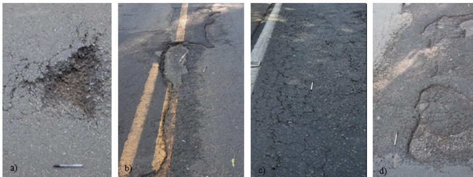
Fotografia 2 - a) Buraco, b) Buraco e deterioração de remendo, c) Couro de jacaré, d) Buraco e deterioração de remendo
