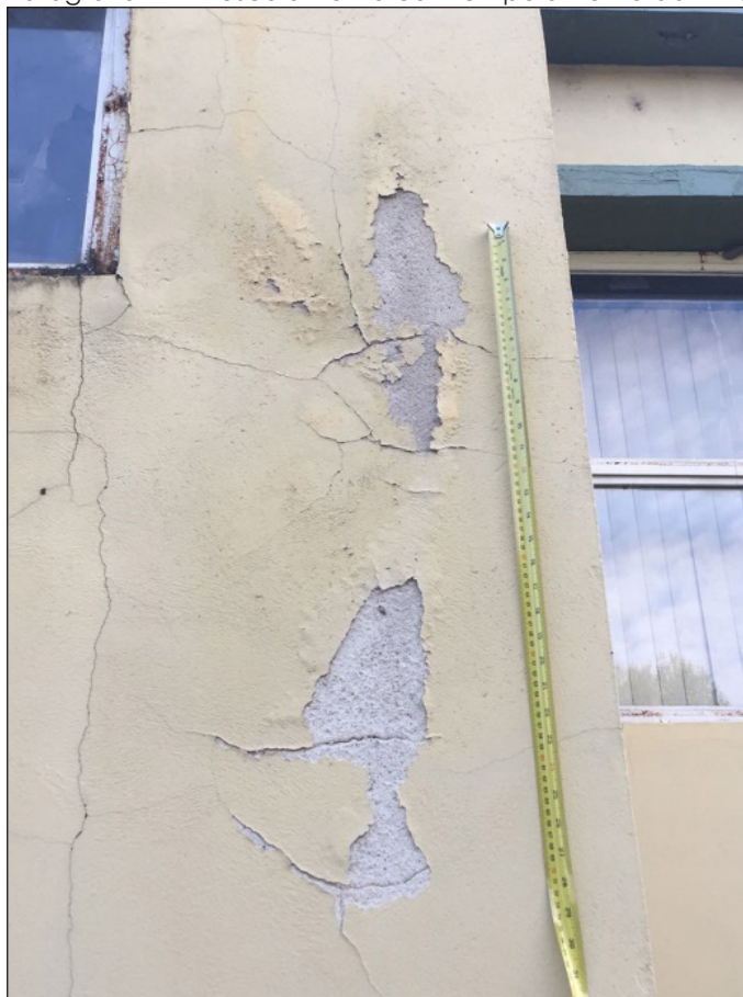
Fotografia 12 - Descolamento com empolamento da tinta
