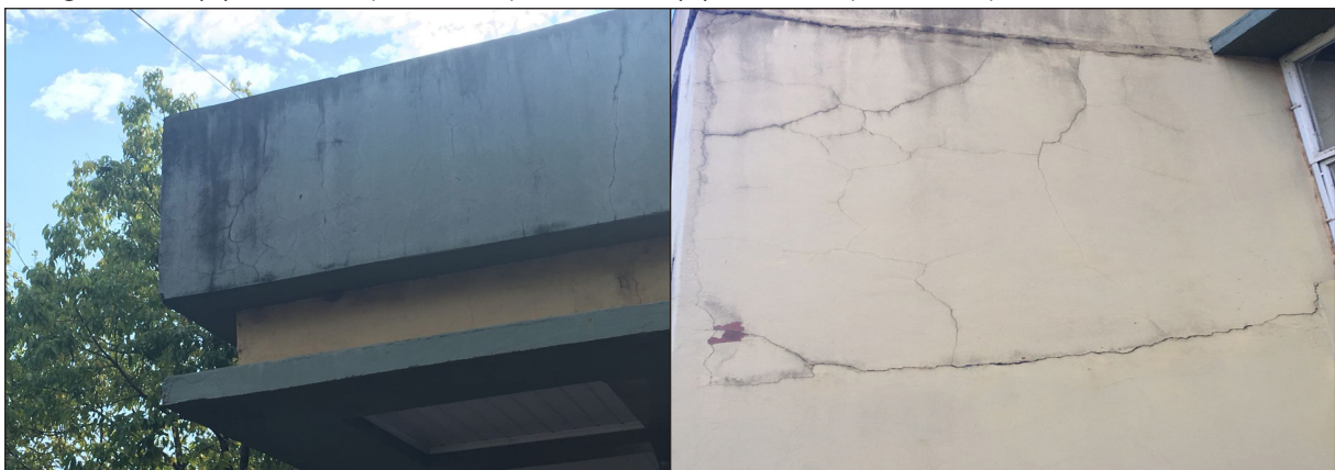
Fotografia 10 - (a) Fissura mapeada na platibanda (b) Fissura mapeada na parede
