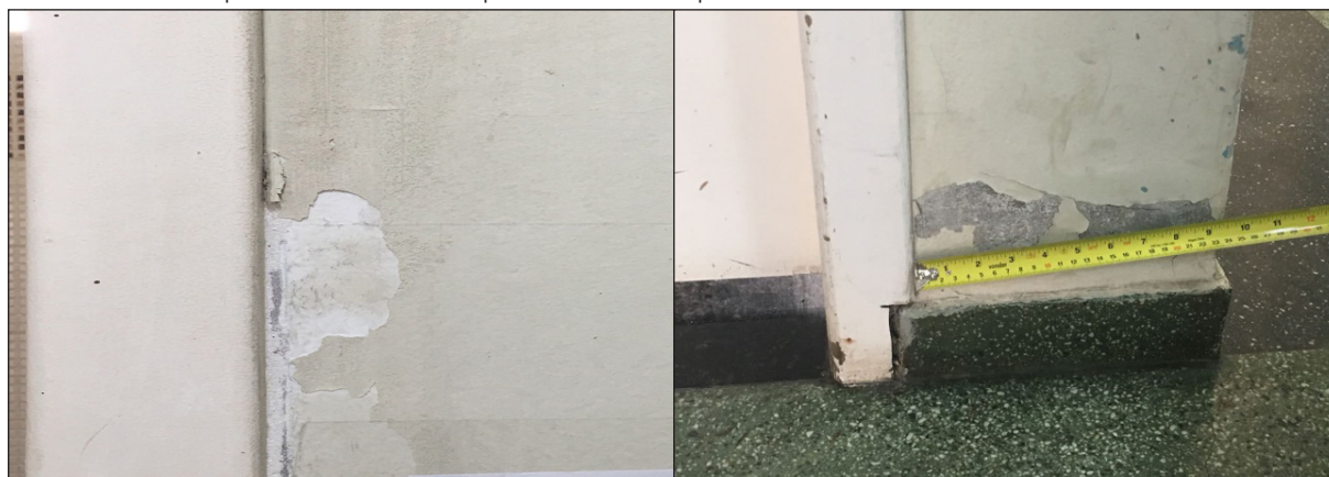
Fotografia 2 - (a) Descolamento com empolamento da tinta próximo a porta (b) Descolamento com empolamento da tinta próximo ao rodapé
