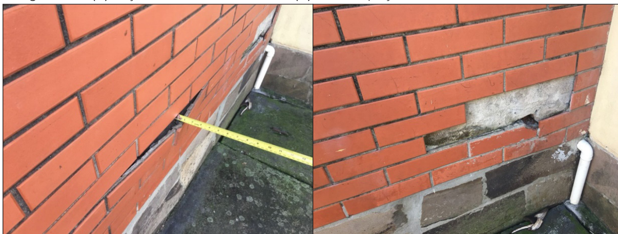
Fotografia 11 - (a) Peças cerâmicas descolando (b) Falta de peças cerâmicas
