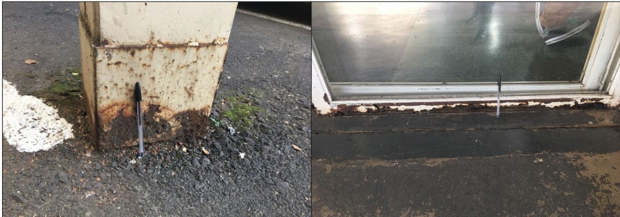
Fotografia 9 – (a) Corrosão estrutura metálica e (b) Corrosão em aberturas
