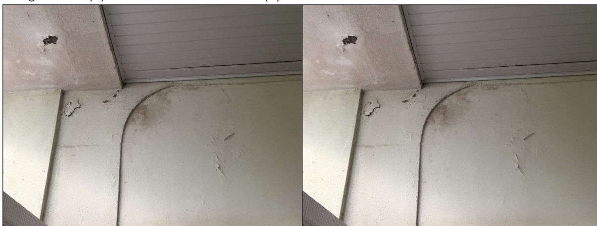
Fotografia 13 - (a) Umidade e descolamento (b) Vesícula e fissura
