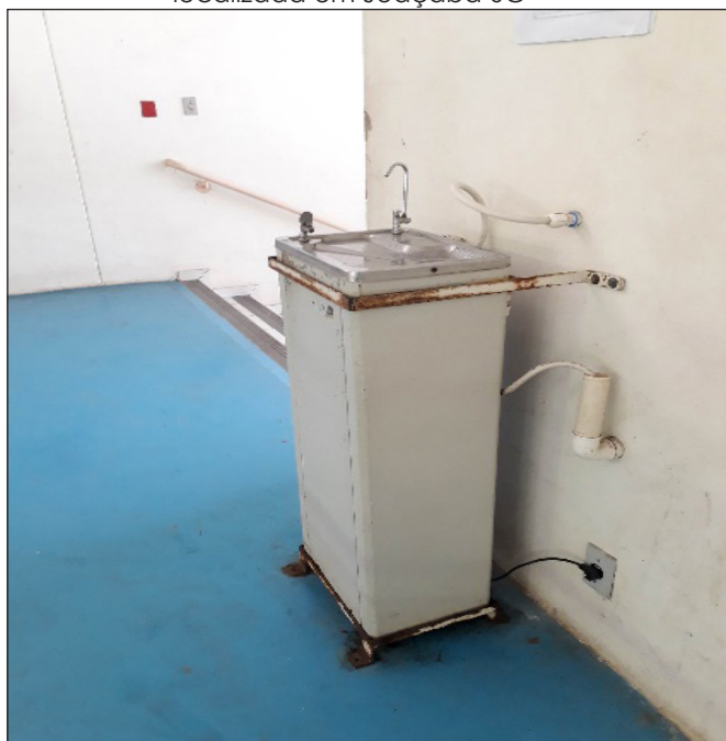
Fotografia 10 - Bebedouro na quadra de esportes localizada no segundo pavimento da Escola de Educação Básica Deputado Nelson Pedrini, localizada em Joaçaba-SC
