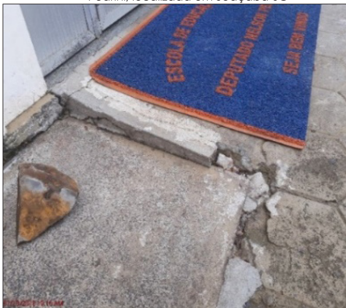
Fotografia 7 - Rampa em mal estado na entrada da Escola de Educação Básica Deputado Nelson Pedrini, localizada em Joaçaba-SC
