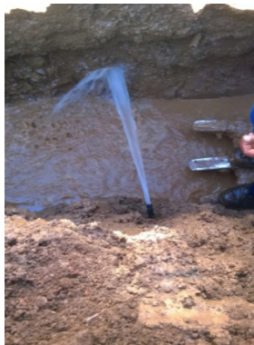
(a) Rompimento da mangueira de água tratada
