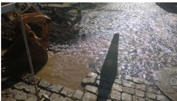
(a) Rompimento da tubulação de água tratada
