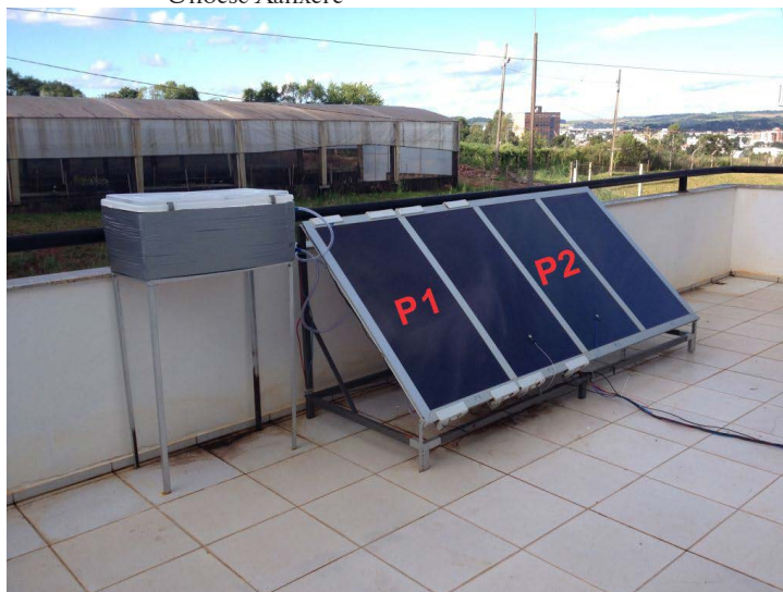
Fotografia 1 – Imagem do sistema completo, montado no Bloco H da Unoesc Xanxerê
